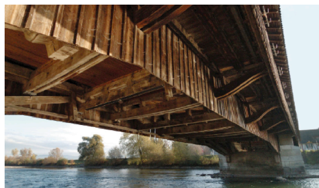
Vista inferior do sistema de reforço
