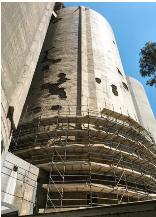
Reparação de Silos no Líbano - Antes
