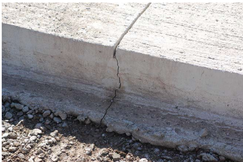
Junta de controlo de fissuração; laje de betão fissurada
