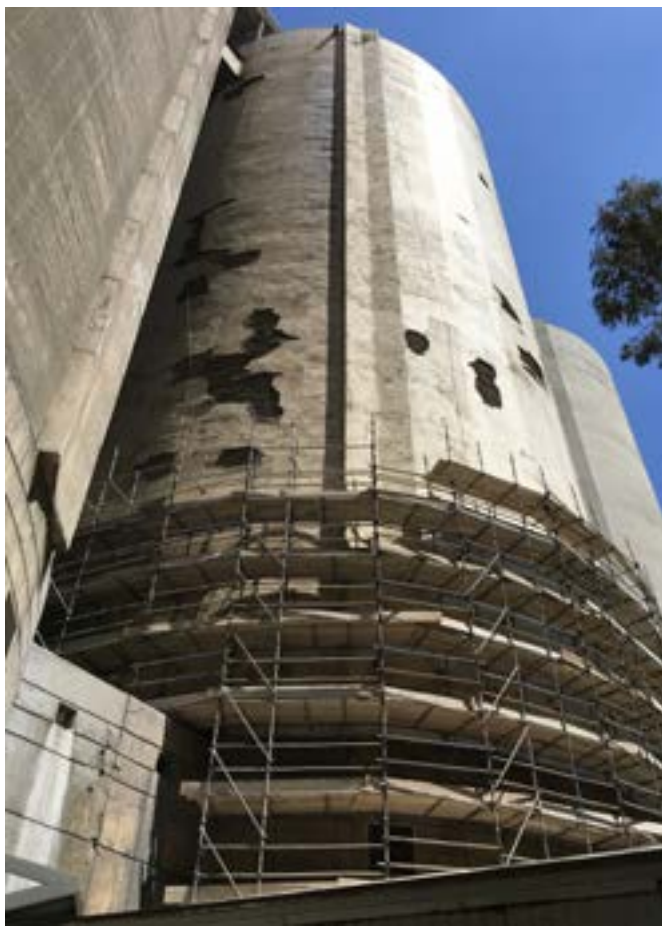
Reparação de Silos no Líbano - Antes
